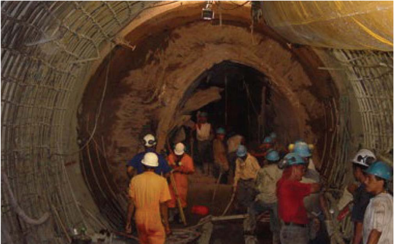
Foto1. Clásica Foto que documenta el cierre de la sección del túnel por squeezing de las filitas. Proyecto Yacambú-Quibor, Ecuador.
