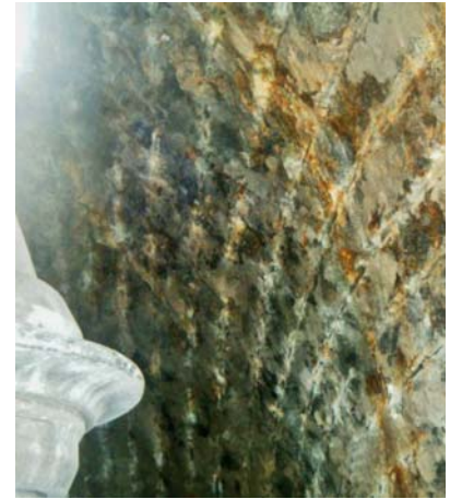
Foto 13: Frente de excavación del Túnel Sur Los Bronces, donde se pueden observar los canales dejados por la acción de los cortadores, en andesitas de regular calidad geomecánica.
