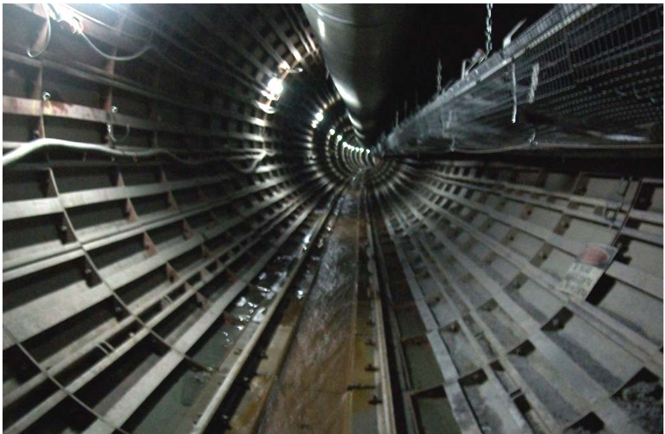
Foto 10: Imagen del interior del Túnel Sur Los Bronces. Se aprecia el sostenimiento con dovelas metálicas en una zona con macizo rocoso de mala calidad geomecánica. En el extremo superior derecho se observa la cinta transportadora.
