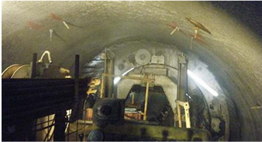
Foto 12: Detalle de fortificación con pernos en la clave del túnel. (Nótese la calidad del corte en roca).
